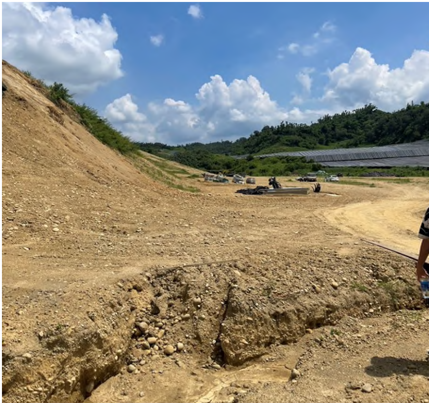
(照片 2：現場勘驗情形 2)
