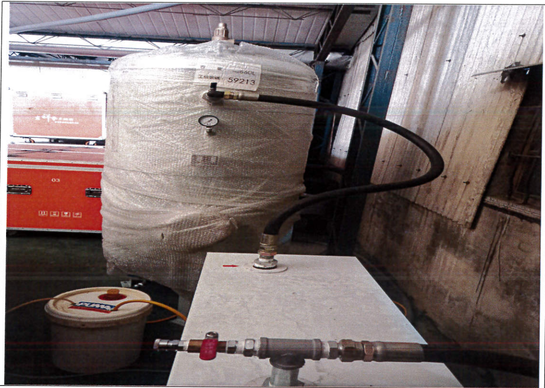
說明：空氣壓縮機組(冷凍式乾燥機)
